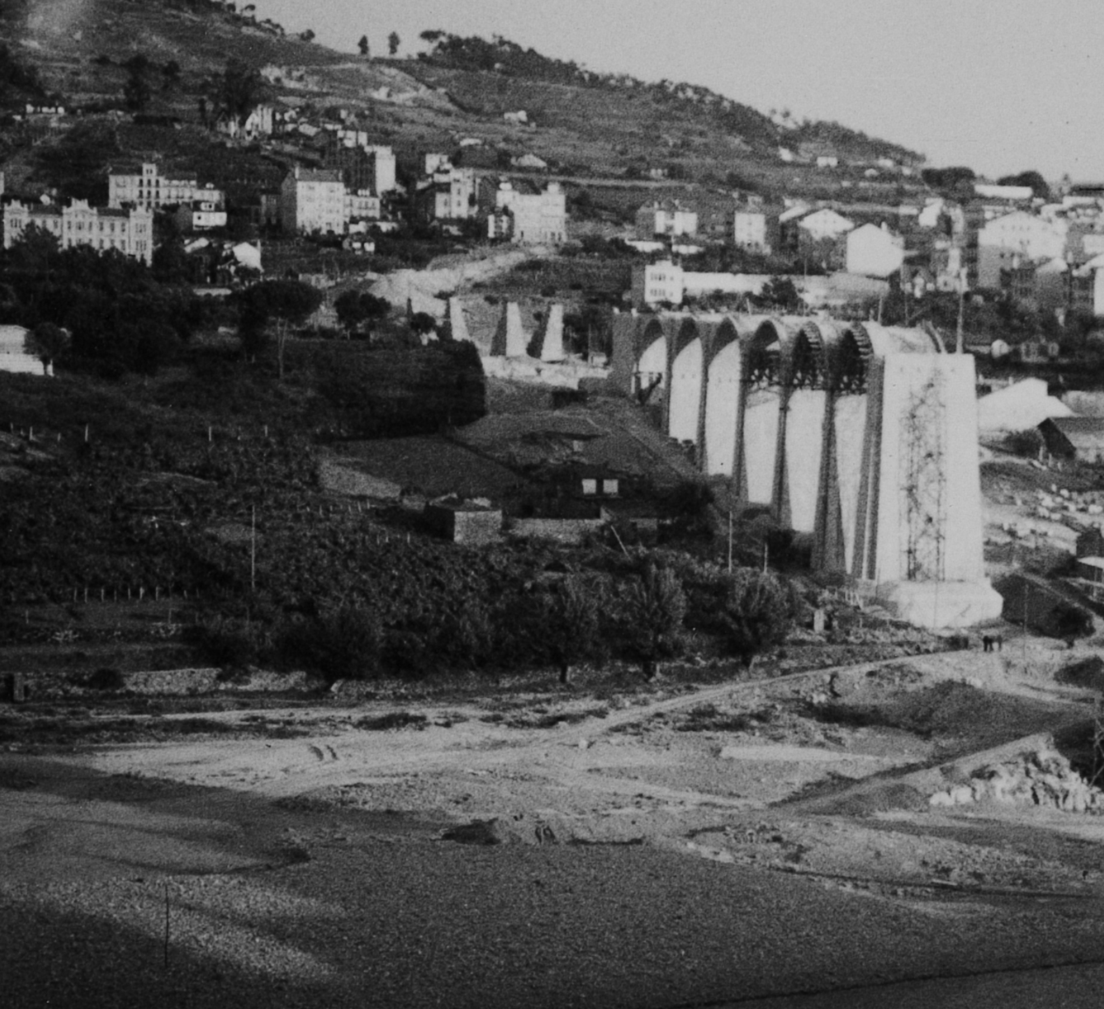
Arriba: A doble página, trabajos de construcción de los tramos de acceso del viaducto Miño, donde se pueden apreciarlo encofrado que dará forma a los arcos y también las bases que soportarán los arcos parabólicos centrales. Al fondo se pueden apreciar los estribos del puente de As Lagoas (Foto Julio García).
